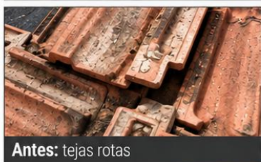
Antes: roberoi en mal estado
